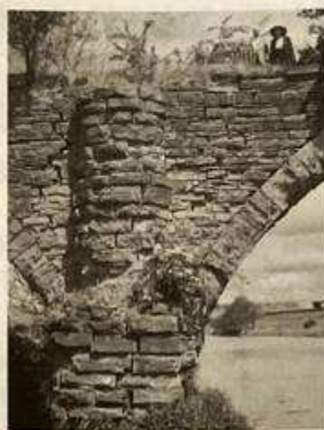
写真1-10 保全前の西側橋脚の状況 スパンドレスの南側壁面にクラックと積石の欠損が見られる。
