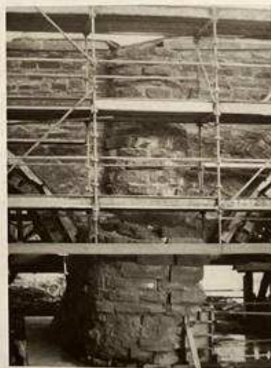
写真1-12 補修工事中の西側橋脚 石積のモルタル充填、断面欠損基礎のコンクリート巻きが施工中。
